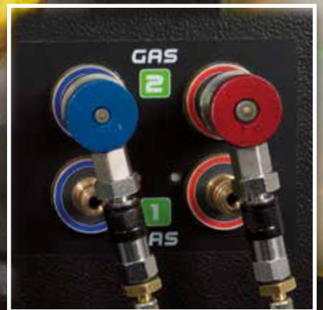
Schnellkupplungen für beide Kältemittel (nur bei 780R)
